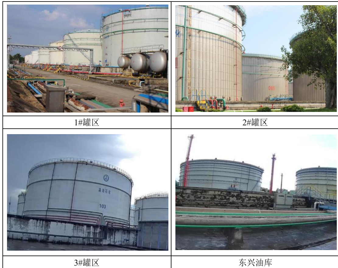
图 3.4-8 后方储罐区现场照片
